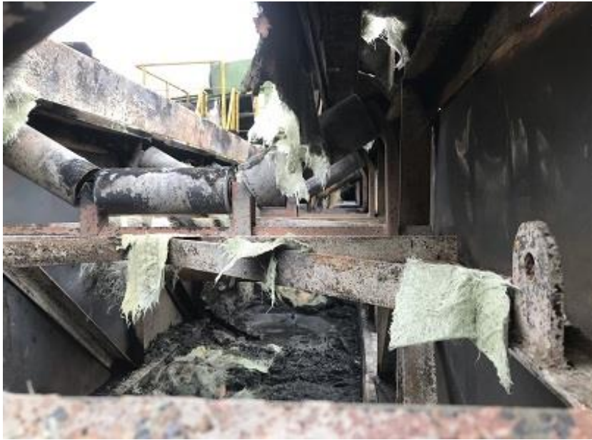
No.3搬送コンベヤの 損傷状況
