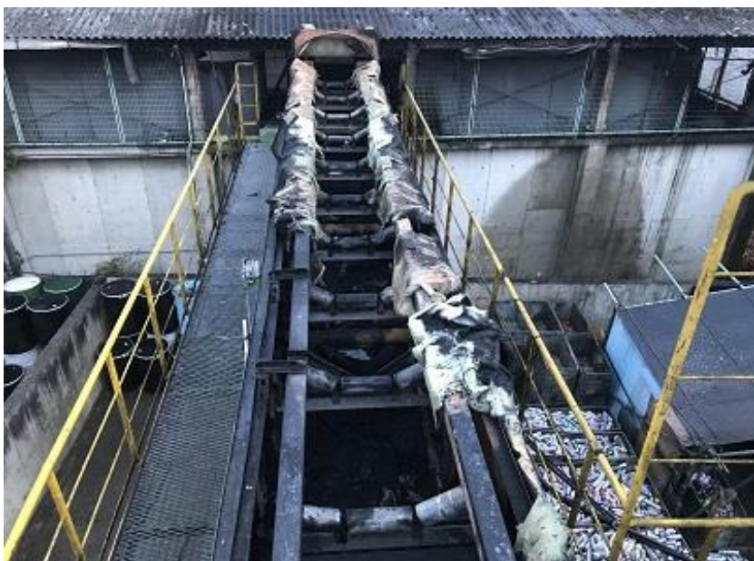
No.3搬送コンベヤの 損傷状況
