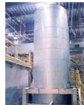
⑦減温塔 排ガス温度を約150℃まで冷却します。
