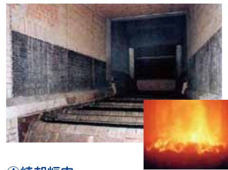
④焼却炉内 炉床の水平ストーカの特殊運動により、ごみを完全燃焼します。
