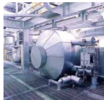
⑥ボイラ 850℃以上の焼却熱をボイラの水管・水冷壁により冷却し、蒸気を発生させます。
