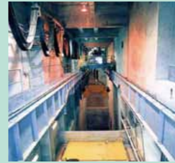
●灰ピットと灰クレーン 一時貯留された焼却灰をトラックに積載します。
