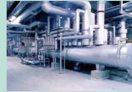
●高圧蒸気だめ ボイラで発生する高圧蒸気を場内に送ります。
