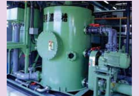
造粒濃縮設備
