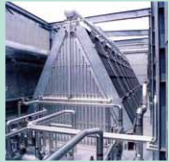
●タービン排気復水器 タービン発電機で利用した蒸気を水に還元します。
