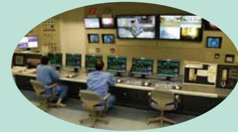
●中央制御室 焼却炉の燃焼制御をはじめ、施設全体の制御・管理を集中的に行っています。
