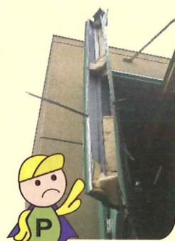
爆発により損傷した破碎棟扉
