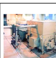
タービン発電機
